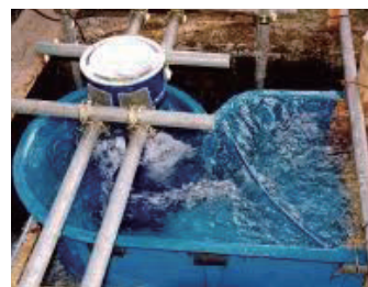
駒沢ミニ水力発電所
